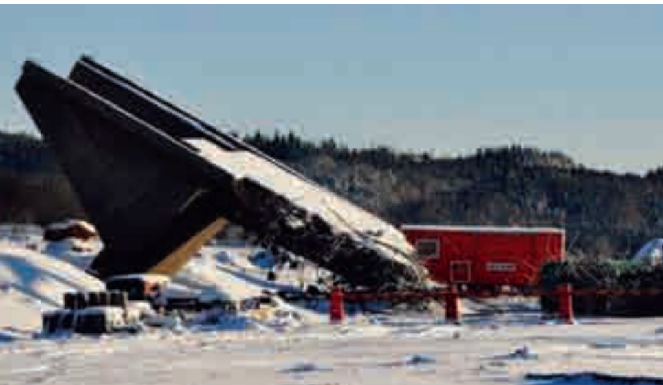
Bron på väg 31 mellan Jönköping och Nässjö som blev tvungen att rivas. När gjutformen togs bort blottades 67 gjutsår.
