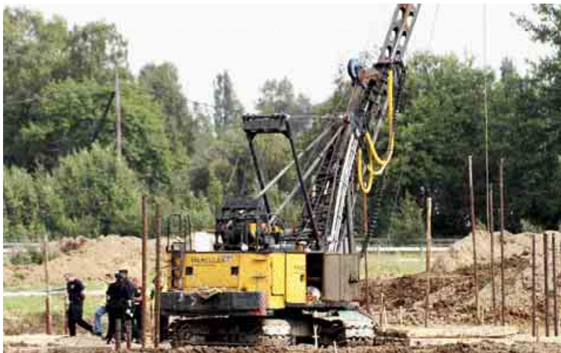
På den här arbetsplatsen i Haparanda lades förbud efter att en dödsolycka inträffat i augusti. Förbudet gällde krav på en förnyad riskbedömning av arbetsförhållanden i samband med pålningsarbete.
