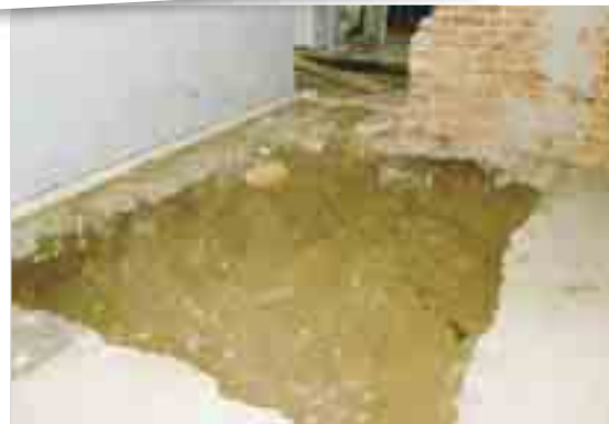
En elektriker föll i den här gropen under augusti.
