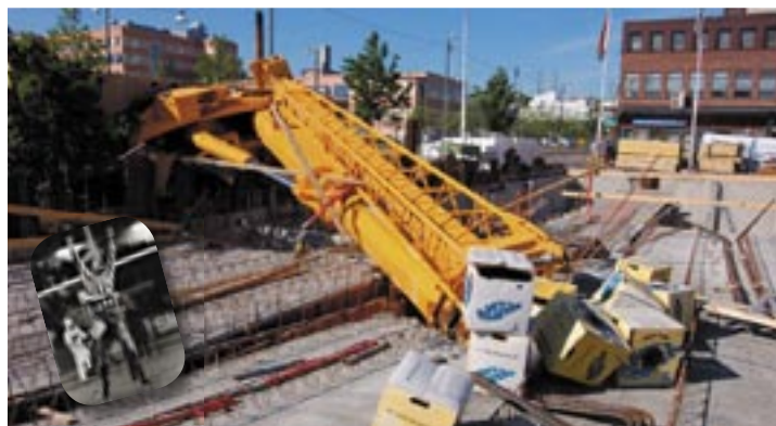
Ett valv krossades när kranen välte på en Peab-arbetsplats i Stockholm. Kranföraren klarade sig med lättare skramor.
