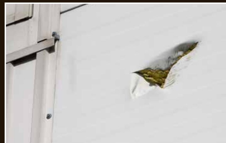
Ett hål i en intilliggande byggnad efter den kraftiga explosionen.
