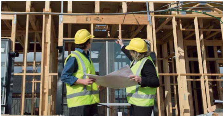
Ungdomar på byggen är de som oftast drabbas av olyckor.
