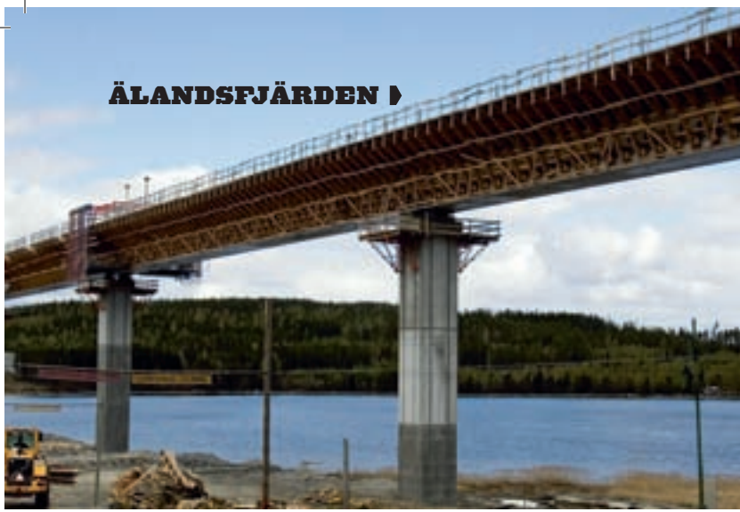
Efter olyckan förstärktes knektarna under bron.
