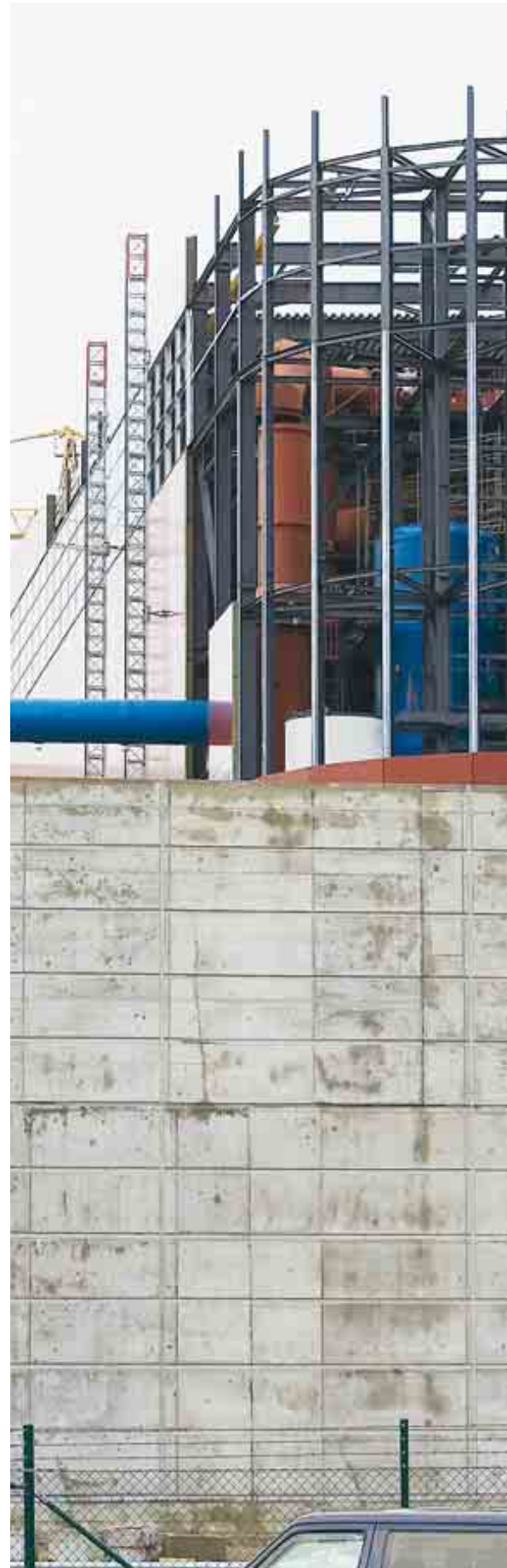
Flaggan utanför värmeverket i Uddevalla hänger på halv stång efter att en byggnadsarbetare omkommit där den elfte december.
