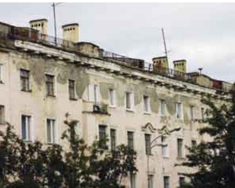
En vanlig syn i dagens Murmansk. Fasaden på ett av stadens äldre hus har lappats med cement och renoveringen är klar. Möjligtvis räckte inte pengarna till puts.
