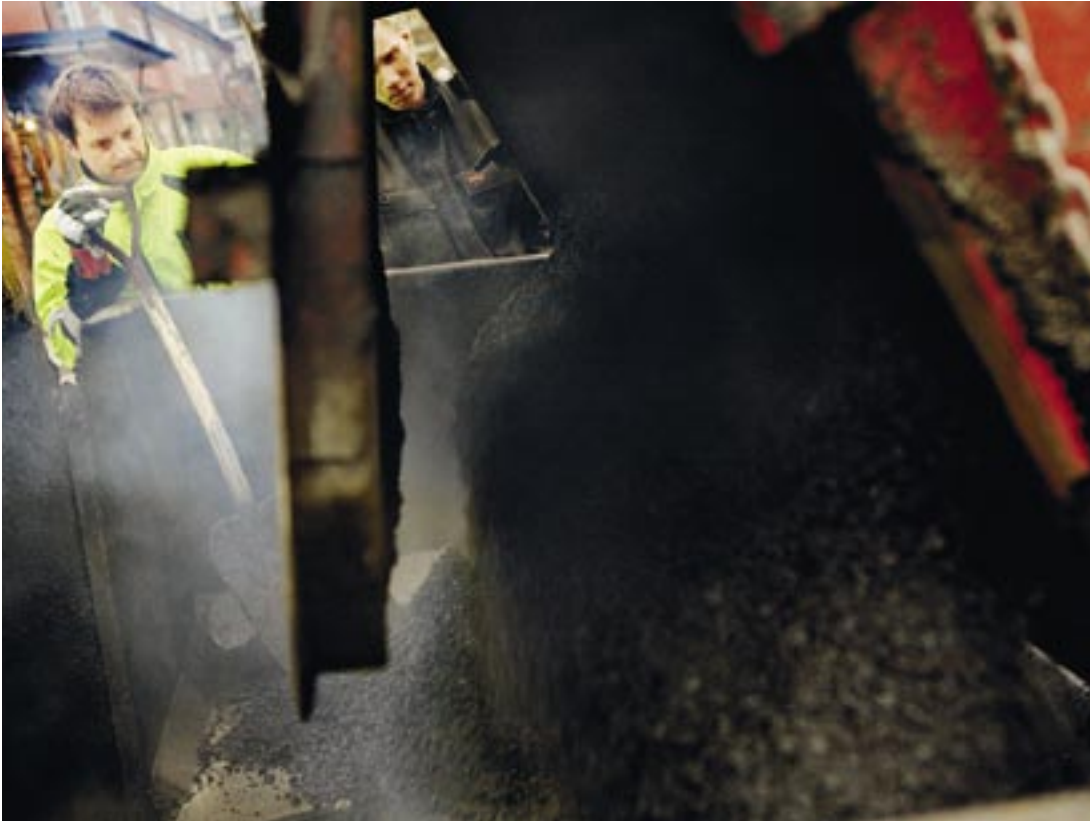
Asfaltsläggarna Mattias Nilsson och Stefan Andersson brukar båda tänka på hur klimatförändringen kommer att påverka vädret. "Rent jobbmässigt är det bra om temperaturen stiger lite. Då slipper vi stämpla på vintern", säger Mattias.
