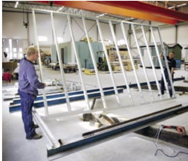
Ola Nilsson och Bengt Månsson har skruvat klart reglarna till en innervägg. En del väggar levereras så här, andra förses först med exempelvis gips och isolering.
