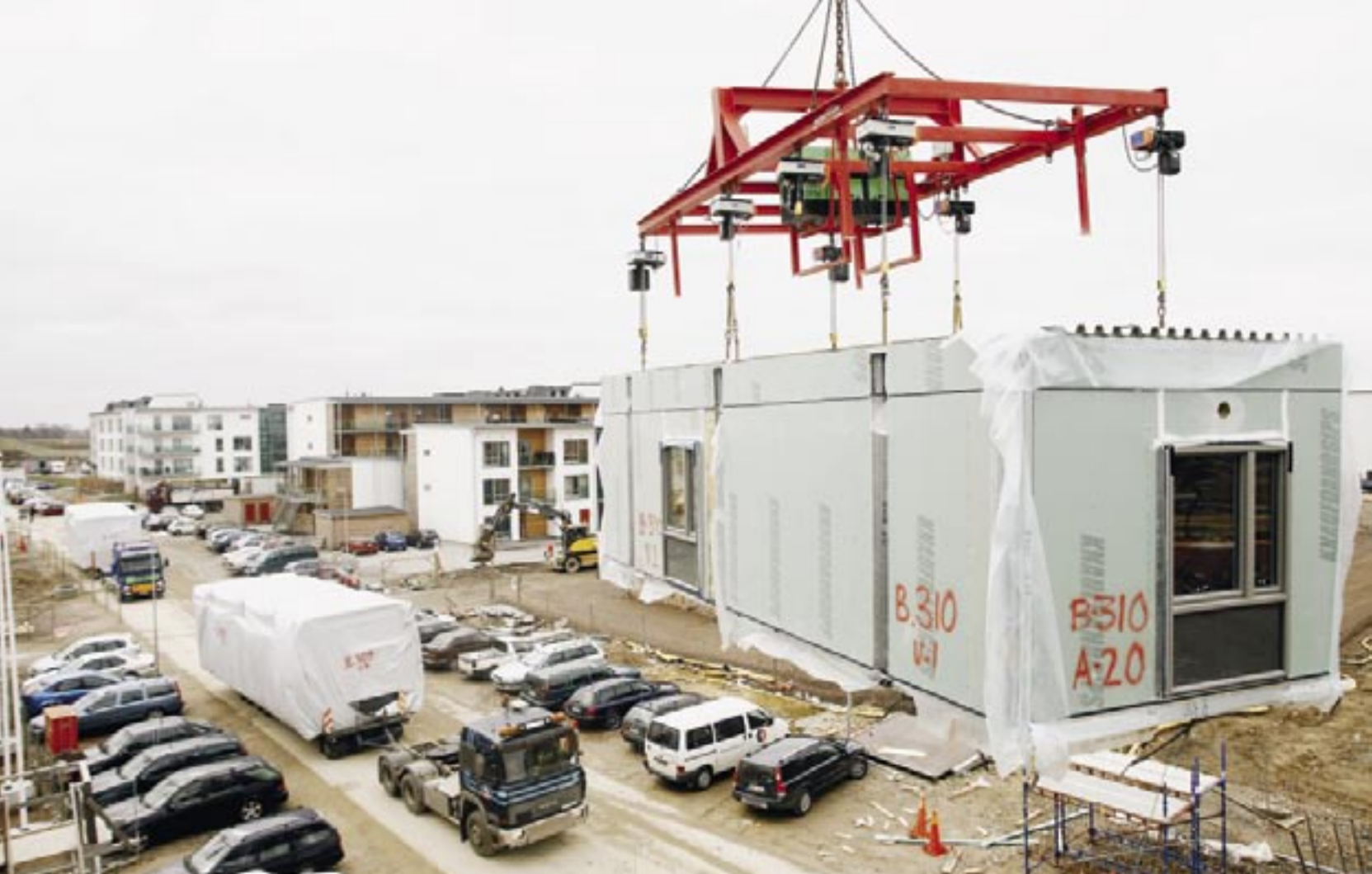
En färdig modul lyfts på plats. I bakgrunden syns området som består av ett oregelbundet mönster av hus med varierat utseende. Fasaderna består av puts, trä, tegel och skivor. 600 av 1200 hyresgäster har redan flyttat in.
