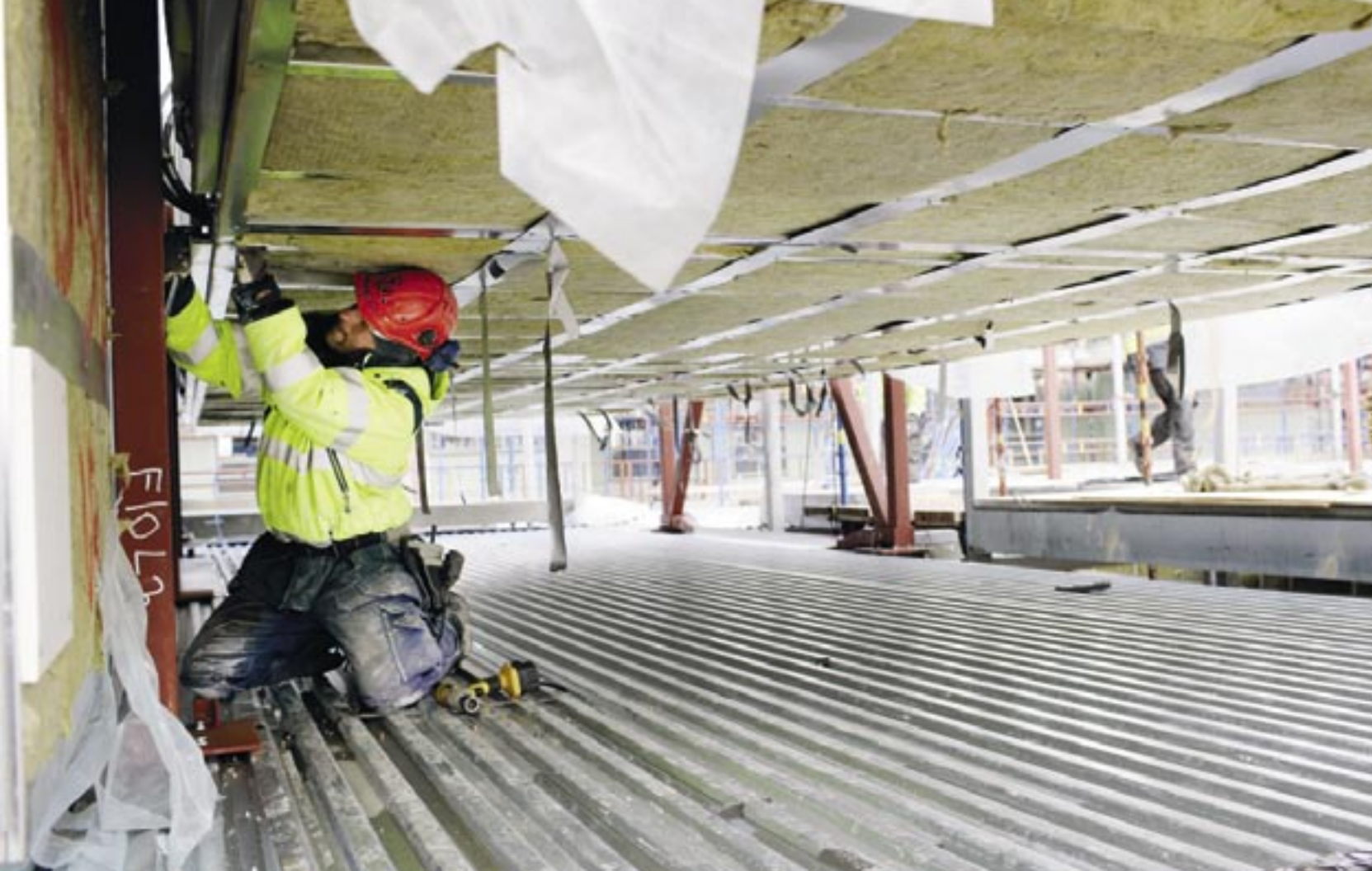
Robban Warczachowski står på taket till en av lägenheterna, och justerar ett vinkeljärn som hamnat snett. Ovanför honom hänger en lägenhetsmodul som väger 10 ton. "Jag försöker arbeta snabbt. Jag vill inte stanna under modulen längre än nödvändigt".
